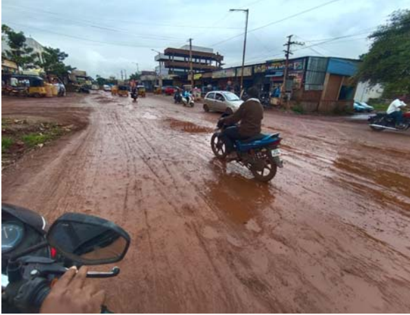
డ్రైనేజ్ నీరు రోడ్డుపైనే మురికి నీరు రోడ్డు పైనే వర్షంనీరు రోడ్డుపైనే మరి మోరీలు ఎక్కువ
